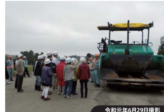
令和元年6月29日撮影 ▲ 現場見学会 (平工業高等学校、相馬西道路(工事状況の確認))
